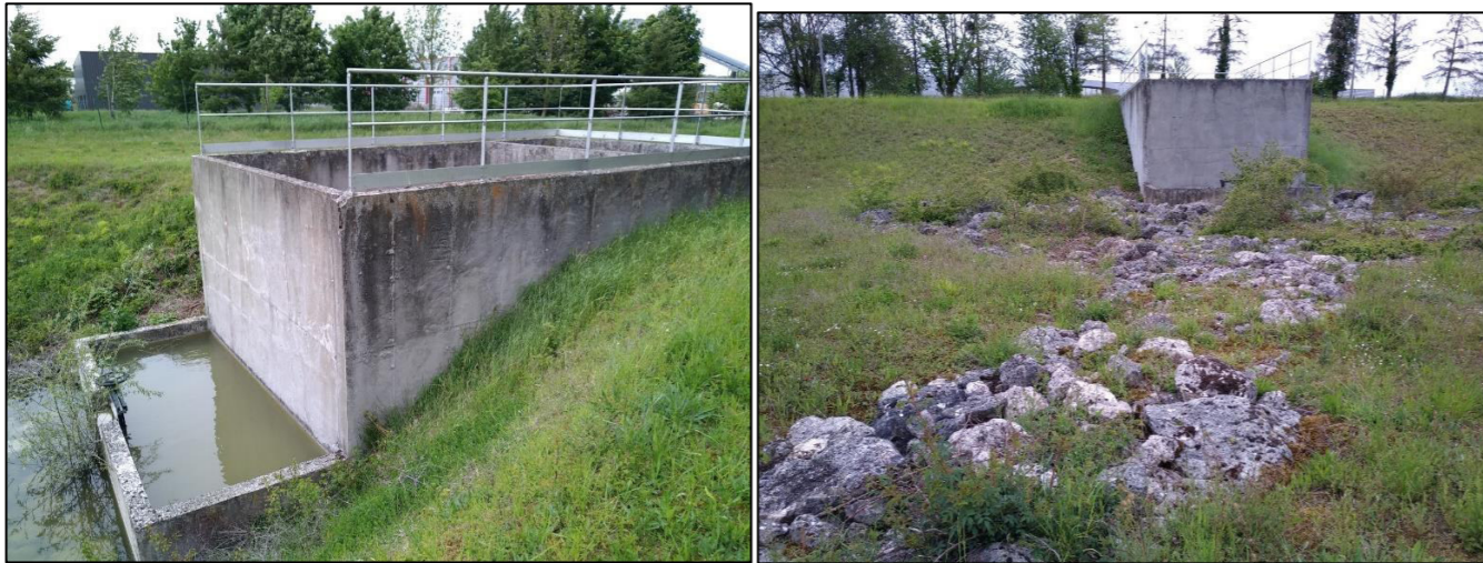
Figure 103 : Illustration des Réservoirs de stockage d'eau, photo prise sur site (Source : NCA Environnement mai 2021).
